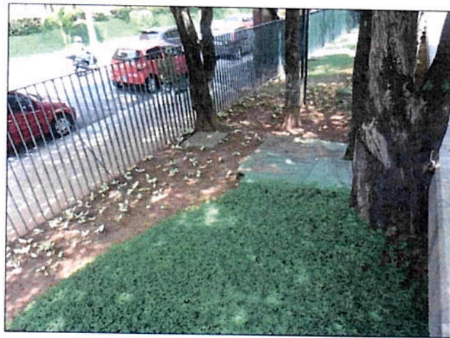
Caixas de passagem de águas pluviais e eletricidade na faixa expropriada.
