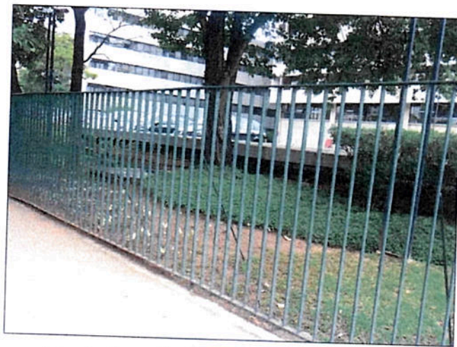
Aspecto do gradil atingido pelo ato expropriatório.
